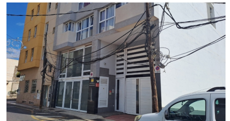
Einfach abenteuerliche Verkabelung
